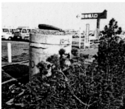
道路に浮き上がったマンホールと配管
