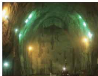
岩盤中におけるLPG備蓄用空洞の施工 (国家石油ガス備蓄基地 高さ30m×幅26m)
