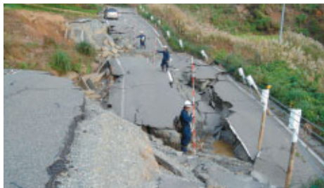
地震被害：新潟中越地震，道路陥没，交通途絶 「南海地震に向けて，学生も調査に」
